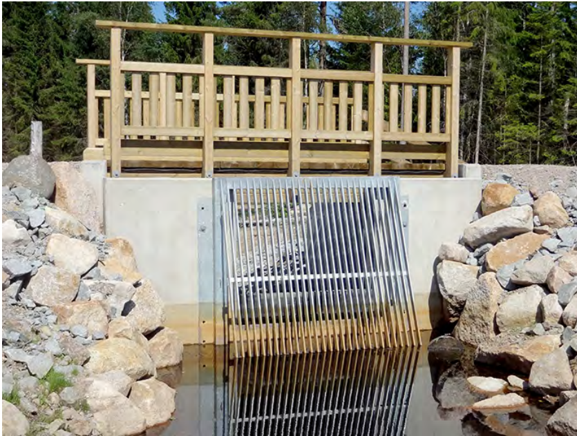
Figur 74. Ett rejält gjutet utlopp säkrar både möjligheten till reglering och att inte fisk tar sig upp i sjön. Foto: Erik Degerman.
