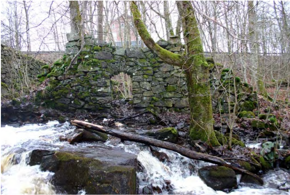
Figur 112. Hovgårdsdammen med kvarnruinen från slutet av 1700-talet efter utrivning av en mindre del av dammen. Dammvallen har bevarats (uppe till vänster) liksom självfallet kvarnruinen nedströms. Kvarnruinen hotas dock att sprängas sönder av träd. Att ta bort träd och rötter försiktigt ökar ruinens "livslängd". Stenån, biflöde till Himleån i Hallands län. Foto: Lars-Göran Pärklint, Ekoll AB.
