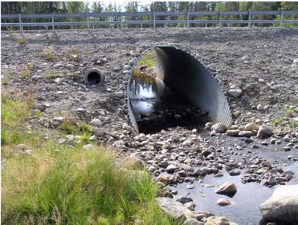
Figur 133. Nedgrävd heltrumma med högre liggande utterpassage i form av en rund betongtrumma i ett biflöde i Öreälvens övre avrinningsområde, Västerbotten. Foto: Erik Degerman.
