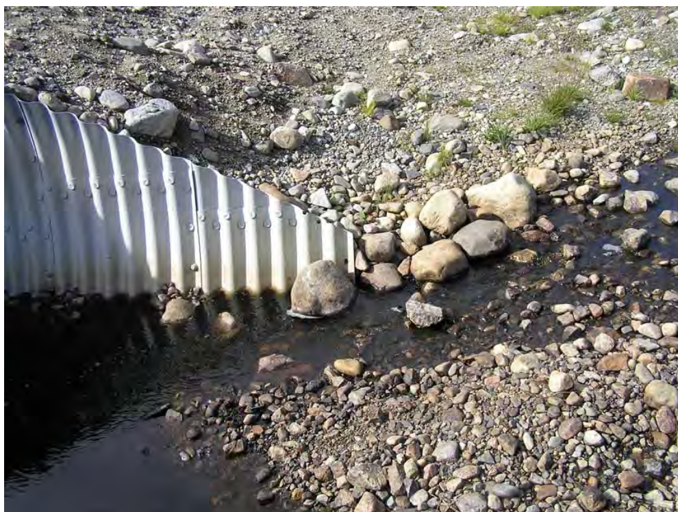
Figur 129. Vid kanten av denna nedgrävda heltrumma har högvatten eroderat. Det är mycket viktigt att erosionssäkra genom att lägga större sten (eventuellt krossten) vid kanten, alternativt gjuta en betongkrage vid sådana här ställen. Gjuts en betongkrage minskar också risken att skräp och grenar fastar uppströms trumman, men i gengäld ökar vattenhastigheten i trumman något. Foto: Erik Degerman.
