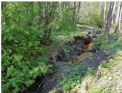
Figur 16. Delsträcka med instabilitet, avsaknad av fungerande svämplan och som bidrar med ökat sedimenttillskott till nedströmsliggande sträckor. Sträckan förväntas behöva mer än 100 år för att utveckla nya svämplan och för att gå in i dynamisk jämvikt. Här skulle det vara dåligt med passiva åtgärder. Foto: Peter Gustafsson, Streams & Lakes Consulting AB.
