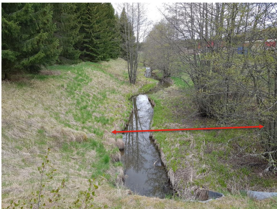
Figur 114. Exempel på en delsträcka som utgjorts av ett brett och djupt dike. Delsträckan har dominerats av sedimentation i och med att det inte funnits energi att transportera ut sedimentet som kommer in i sträckan. Vattendragsfåran har nu blivit så smal som sin naturliga bankfullbredd (ca 2.5 m) och gått in i dynamisk jämvikt där mängden sediment in i sträckan är samma som går ut. Den igensedimenterade ytan utgör ett välutvecklat nytt svämplan. Lutningen har också ökat under denna förändring. Pilen visar dikets bredd när det var nygrävt. Notera gärna att vattendraget på egen hand har skapat en morfologi som är mycket likt ett tvåstegsdike. Foto: Peter Gustafsson, Streams & Lakes Consulting AB.
