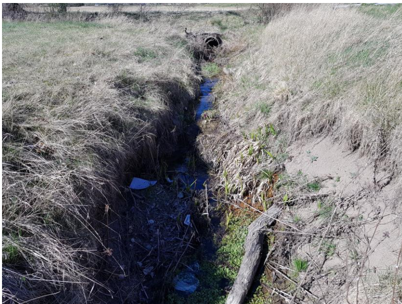
Figur 88. Exempel på tvåstegsdike. Här fanns det tidigare en kulvert med dräneringsvatten samt ett dike som bland annat avvattnade ett vägområde och resterna av ett äldre bäcksystem. Den tidigare lösningen var instabil och hade sämre förutsättningar för biologisk mångfald. Nedersta bilden är innan åtgärd, övriga i direkt anslutning till åtgärd. Syftet med dessa åtgärder var ökad morfologisk stabilitet samt ökade förutsättningar för biologisk mångfald. Foto: Peter Gustafsson, Streams & Lakes Consulting AB.
