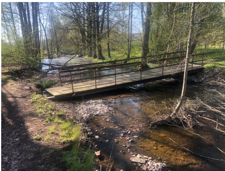
Figur 111. Delsträcka med kraftig sedimentation (bottenhöjning) och stranderosion. Fårans kanter har tidigare legat där det lilla trädet står i fåran. Orsaken är en uppströmsliggande kanalisering av en C-sträcka vilket resulterat i tillskott av grus på denna sträcka. Delsträckan saknar i dagsläget höljor vilket påverkat både fiskfaunan och stormusselfaunan (bl a tjockskalig målarmussla). Foto: Per Saarinen.
