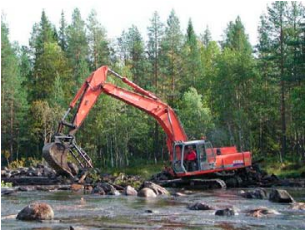
Restaurering av kanaliserad fåra med grävmaskin och gällerskopa i Abmoälven, ett biflöde till Piteälven. En stenlista som avskilt fåran från strandskogen demonteras och blocken läggs ut i fåran. Foto: Christer Nilsson.
