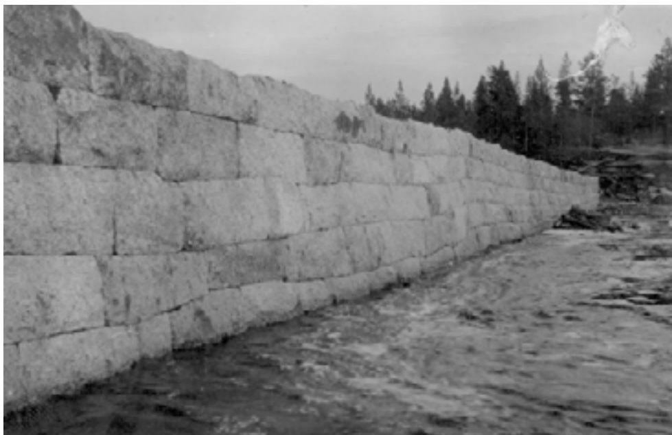
Kilstensmur, dvs en mur av huggna stenar som ofta sammanfogades med krampor. Foto: Umeå flottningsförenings arkiv, Folkrörelsearkivet vid Västerbottens museum, Umeå (fotograf okänd).
